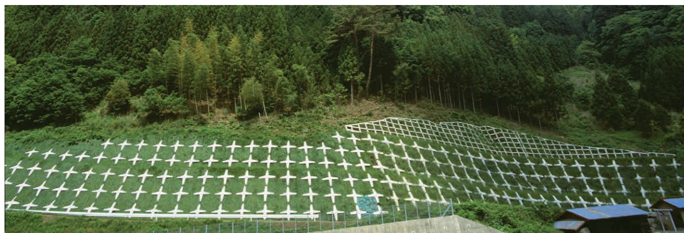
スーパーメタルフレーム(左)/PCフレーム(右) 三遠南信草木改良工事(静岡県)
