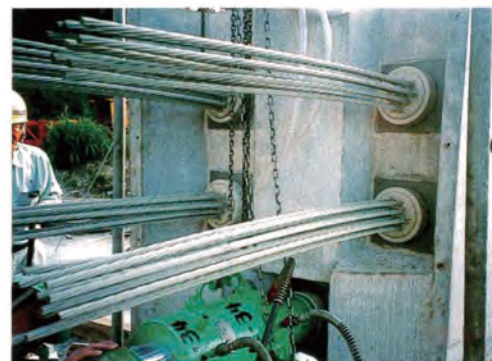
SC-S緊張後のアンカーヘッドとの状況
