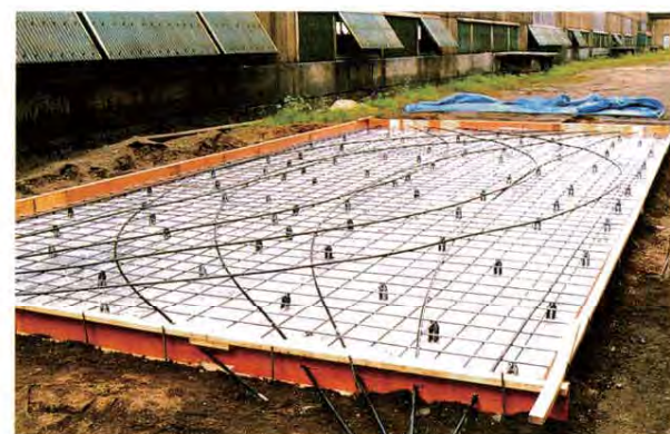
SC-U 1 とPC鋼より線の配置状況
