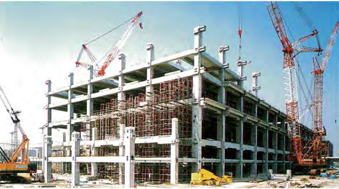
22 JR東京貨物ターミナル駅複合施設
